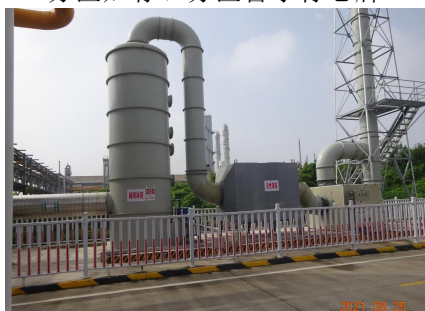
危废库废气净化装置
