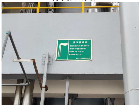
废气排口标识 FQ-0075-32 (8#盐酸合成炉排口)
