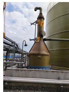
中间罐区盐酸贮罐废气一级水吸收处理装置及排放口
