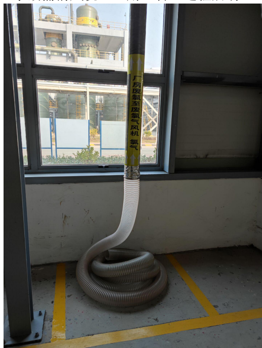
法兰等易泄漏处布置抽空软管
