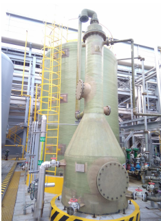
电解工序盐酸储槽废气一级水吸收处理装置及排放口
