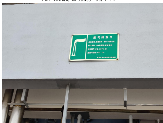
废气排口标识 FQ-0075-34 (10#盐酸合成炉排口)
