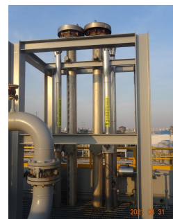
FQ-0075-33 和 FQ-0075-34 排气筒
