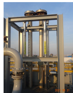
FQ-0075-33 和 FQ-0075-34 排 气筒
