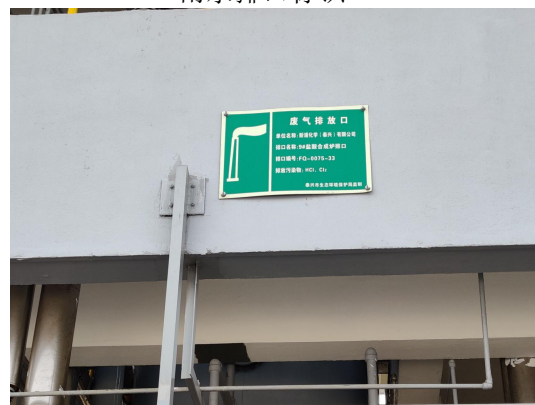
废气排口标识 FQ-0075-33 (9#盐酸合成炉排口)
