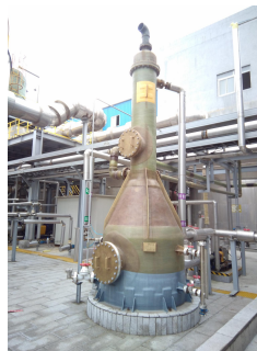
一次盐水盐酸高位槽、氯水高位槽废气一级碱吸收处理装置及排放口
