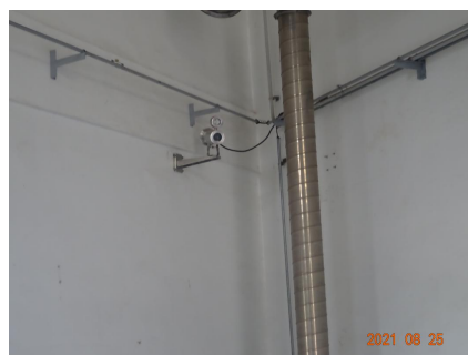
危废库内监控设施
