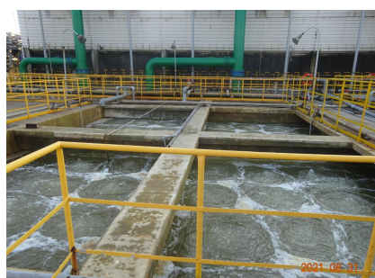
无机废水处理站
