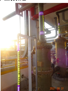
盐酸工序高纯盐酸贮槽废气一级水吸收处理装置及排放口
