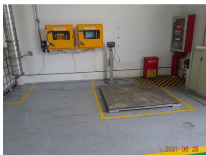
对讲机、磅秤、消防设施
