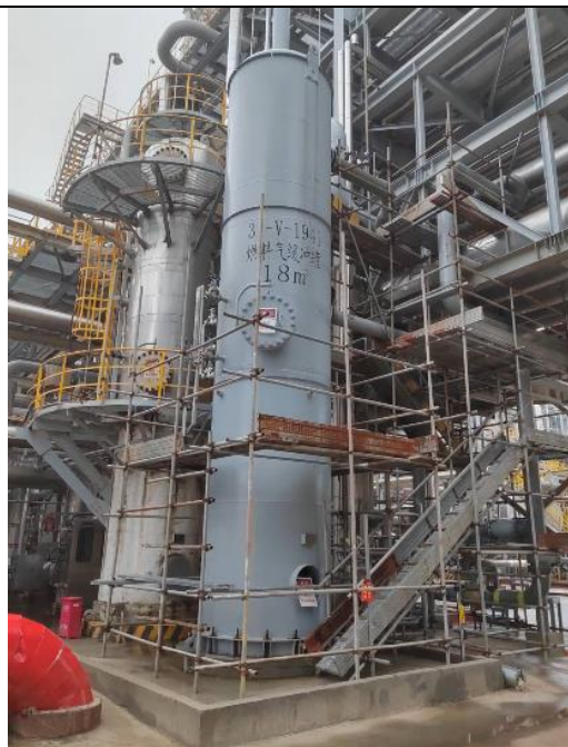
燃料气缓冲罐
