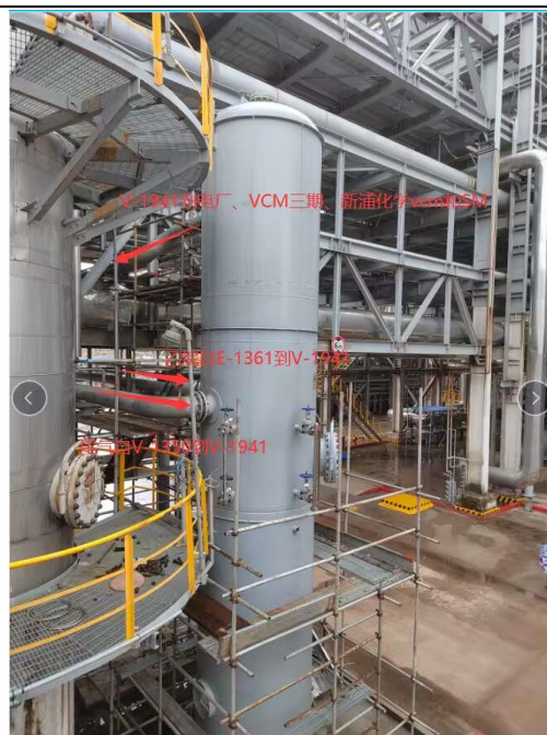
燃料气缓冲罐配套管道
