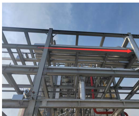
码头至新建丙烷罐区低温丙烷管线（厂内）
