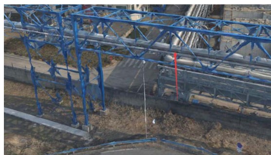
码头至新建丙烷罐区低温丙烷管线（厂外）
