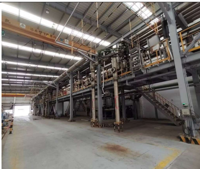
液氯槽车接卸平台
