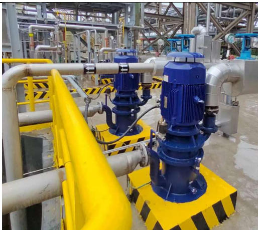
酸罐区中和池提升泵
