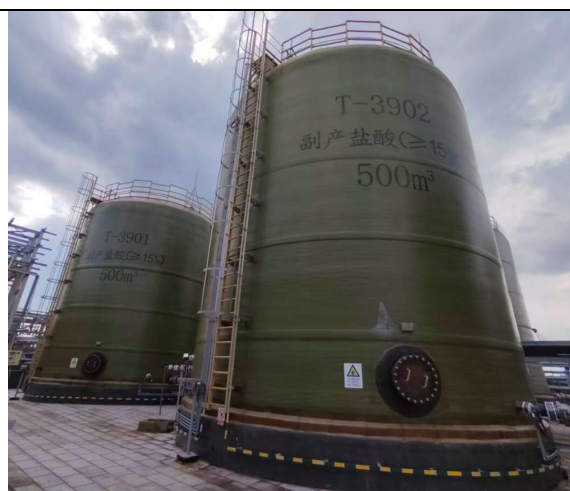
副产盐酸储罐
