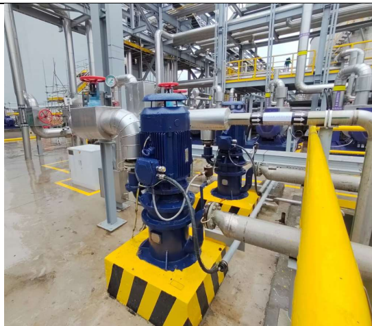
碱罐区中和池污水提升泵
