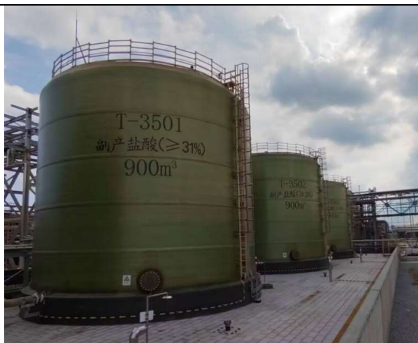
工业盐酸储罐
