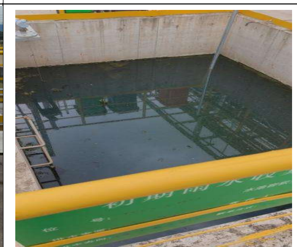
中试装置区初期雨水池
