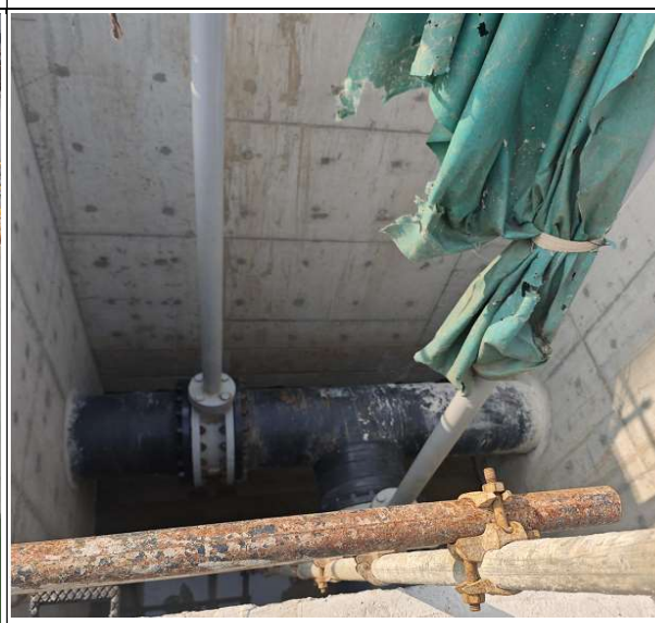
PDH 厂区雨水系统和污水处理设施的切换阀
