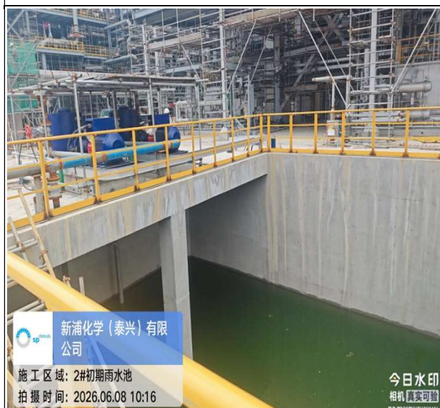
PDH 厂区初期雨水池
