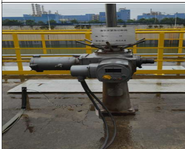
北厂区、烯烃厂区事故污水（含污染消防水和污染雨水）进入污水处理设施的切换阀
